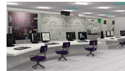
制御システム
