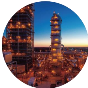
CO2回収設備
