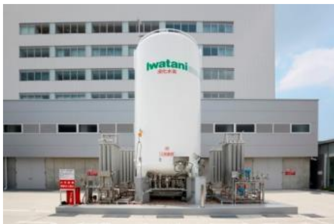
液化水素貯槽
