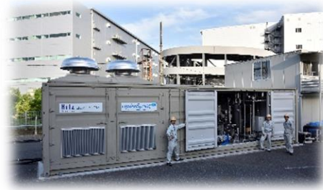
水素発生装置
