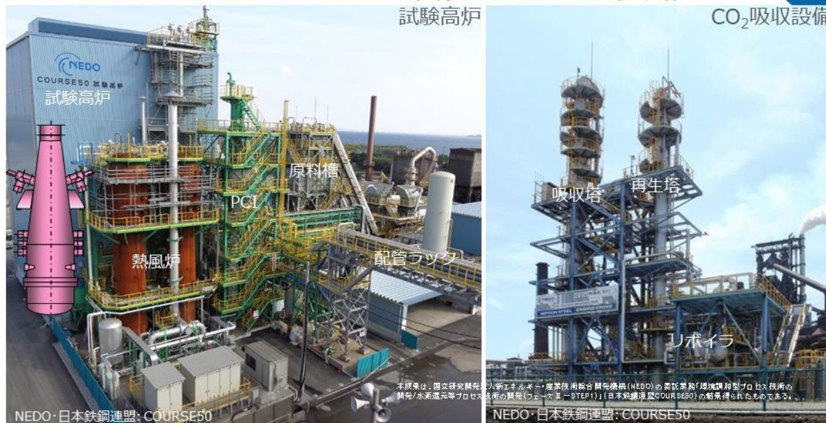
COURSE50プロジェクト 試験高炉・CO 2 吸収設備
