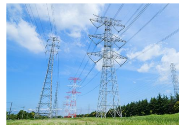
送配電・需給管理
