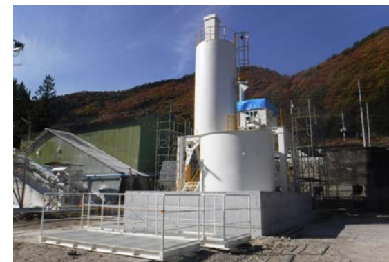
写真3 粉末石灰受入供給施設(H30年度より本格稼働予定)
