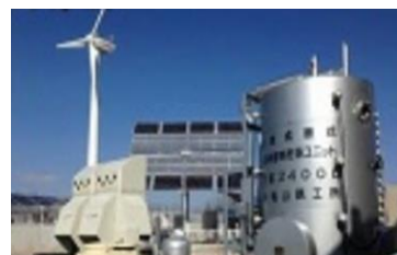
「温度成層式蓄熱・貯湯システム」業務用蓄熱タンク (株)亀山鉄工所
