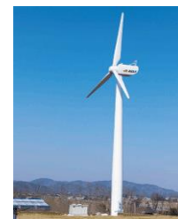
風力発電設備
