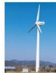
④風力発電設備(FREA)
