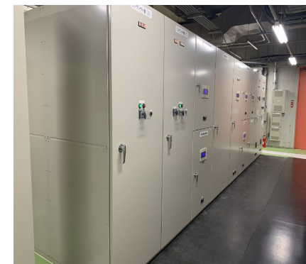
受変電設備（改修後）
