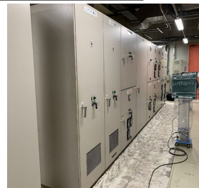
受変電設備（改修前）
