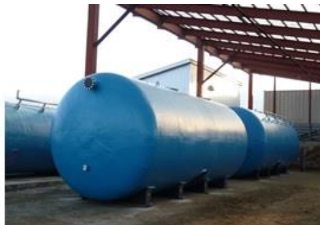
■ 原料自動投入装置・原料前処理装置と FRP製メタン発酵槽（高温乾式）
