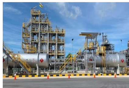
■ブルネイに設置した水素化プラント
