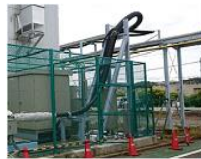
■敷設した超電導ケーブル 専用ラックへの立ち上がり水平部分
