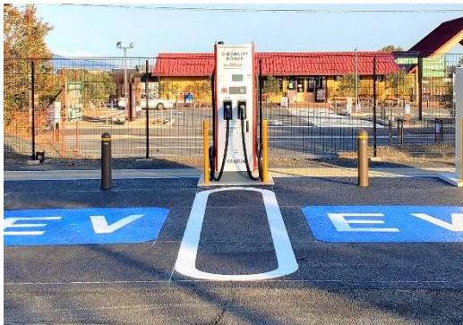
● 伊勢湾岸道 湾岸長島PA（上） 1口最大150kW
