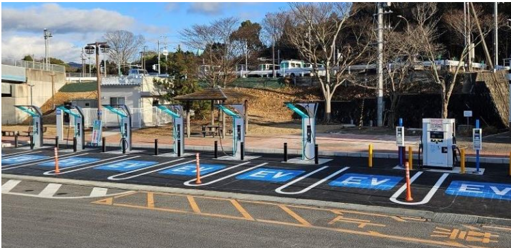
● 名神道 草津PA（下） 6口マルチ充電器・1口最大90kW ※右は既設充電器（90kW・2口）
