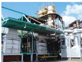
電池の無害化 処理工程
