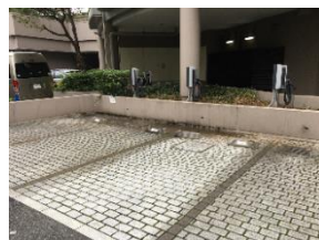
マンションの充電スペース
