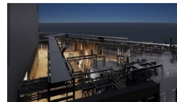
バイオガス発電設備
