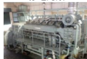
例：自家発電機の整備
