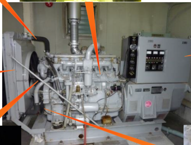
非常用自家発電設備
