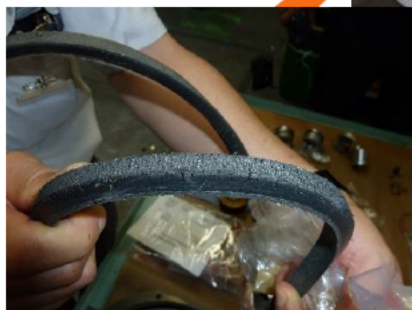
Vベルトの劣化
