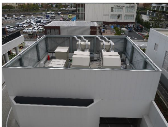
■ 電気設備周囲の塀
