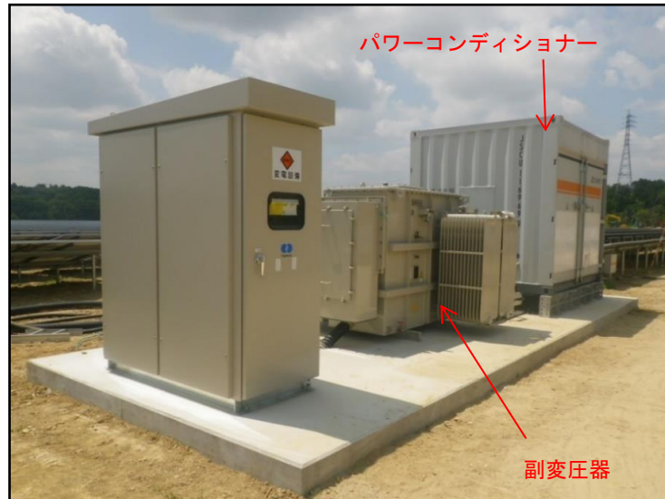
図 7-1 副変圧器とパワーコンディショナーの設置状況例
