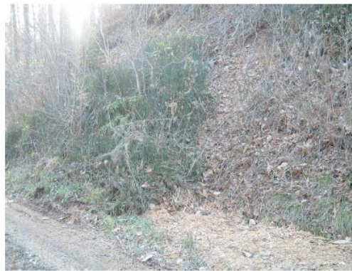
図-3 崩落土砂が被さった側溝充填型
