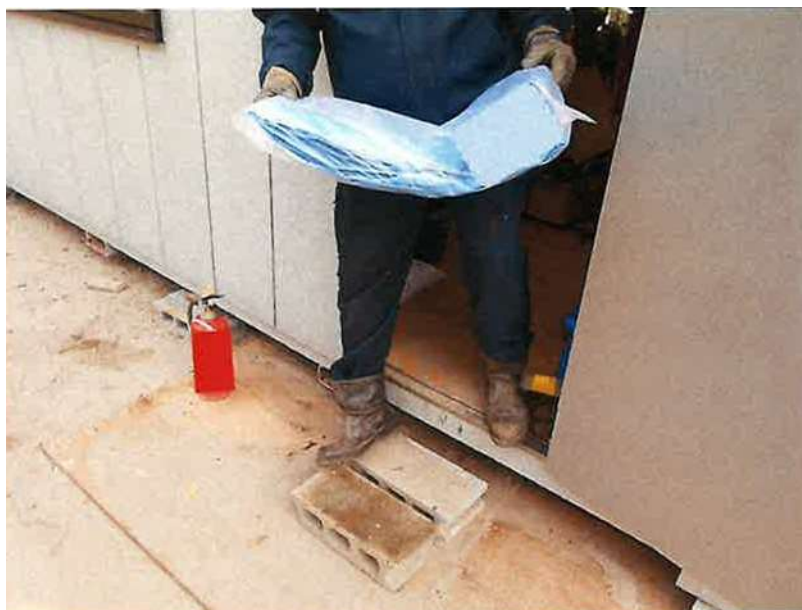
写真2 災害発生状況（足の踏み外し）
