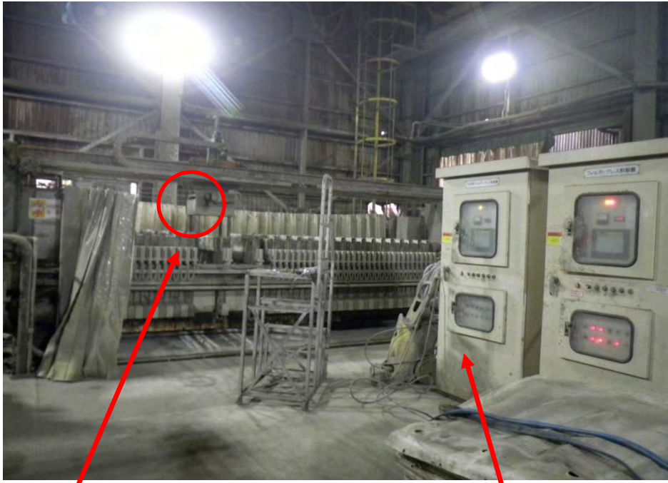
罹災箇所（ケーシング部分）
