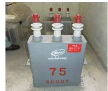
電力用コンデンサー
