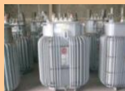
高圧トランス
