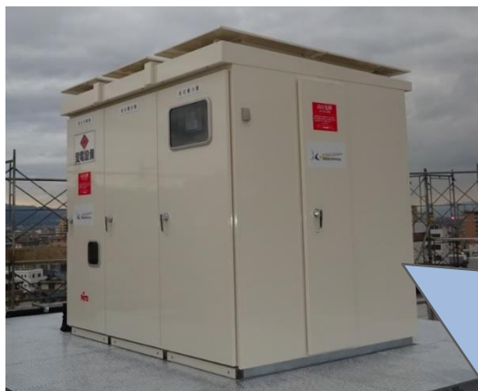
受電設備（キュービクル）
