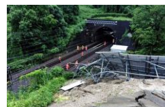
＜太陽光パネルの崩落＞
