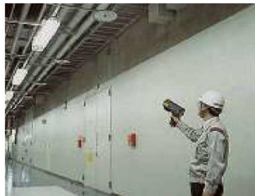
レーザーメタン検知器を用いた天井ガス配管の漏えい検査
