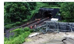
＜太陽光パネルの崩落＞
