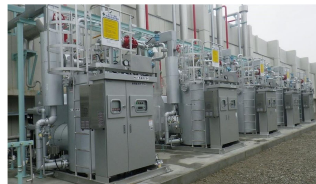
水素燃料ボイラーの導入例
