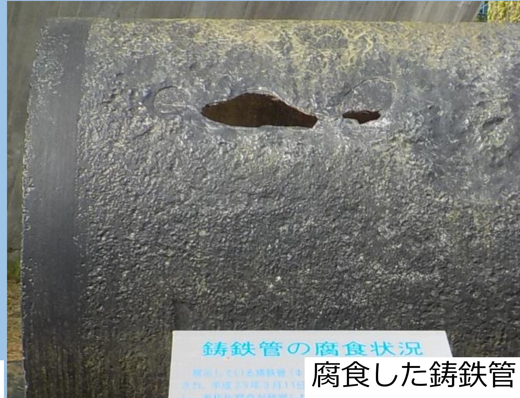
劣化による漏水状況
