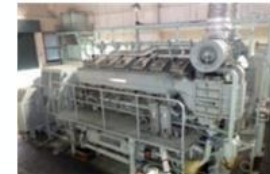
例：自家発電機
