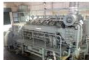
例：自家発電機の整備
