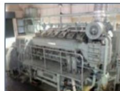
停電対策: 自家発電機の整備
