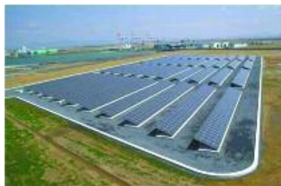
図4. 響灘太陽光発電所
