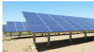
コープ・市民ソーラー とかち南町発電所
