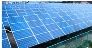
コープ・市民ソーラー とかち川西発電所
