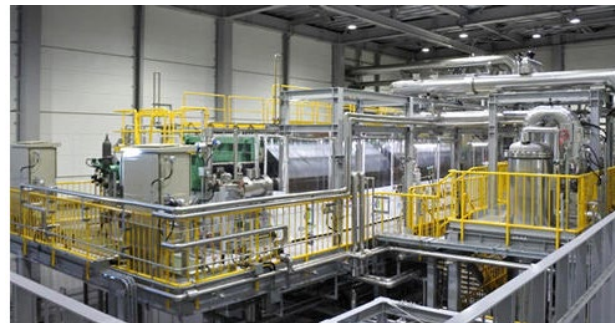
10MWの水電解装置
