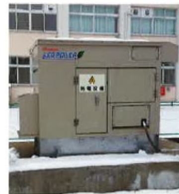
LPガス非常用発電機
