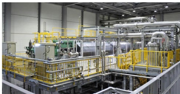
10MWの水電解装置
