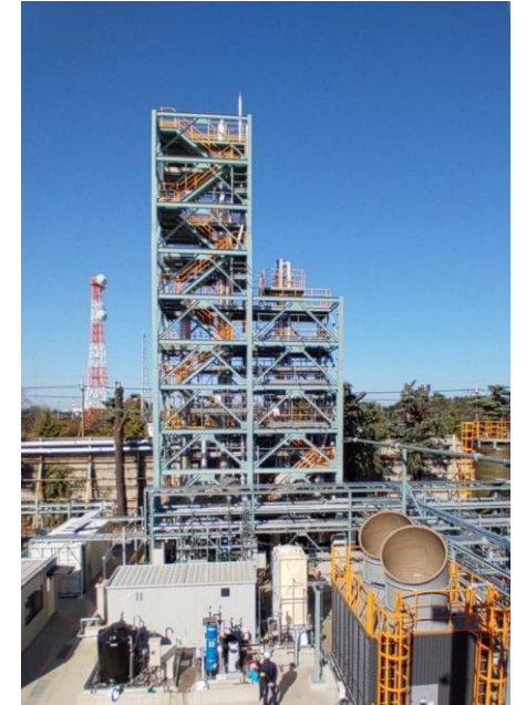
設備サイズ：600m 2 、25mH 化学吸収法によるCO 2 回収 実証設備（能力：10t/日）
