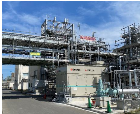
合成ガス製造 (逆シフト反応設備)
