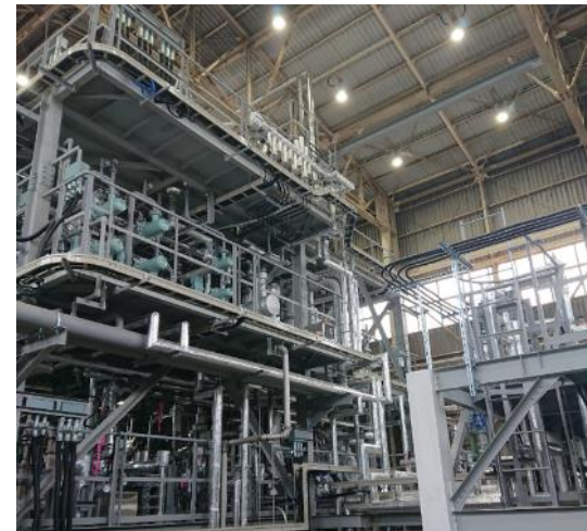
合成原油製造 (FT合成反応設備)
