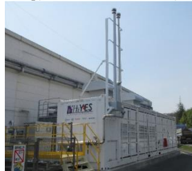
住友ゴム工業(株)の白河工場で新たに稼働した「やまなしモデルP2Gシステム」(2025年4月) (出典) 住友ゴム(株)HP
