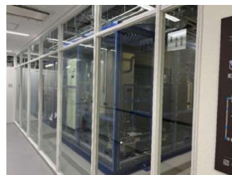
進工業(株)の小浜工場に導入した水電解装置(2024年6月) (出典) カナデビア(株)HP
