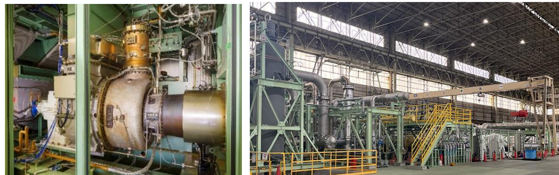
IHI製アンモニア専焼2MW級ガスタービン
