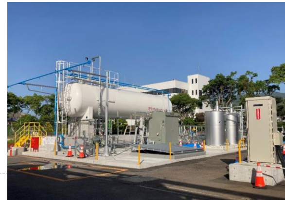
アンモニア供給設備 (GI基金事業で新規に導入)
