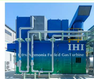
アンモニア専焼ガスタービン（定格出力：2MW）
