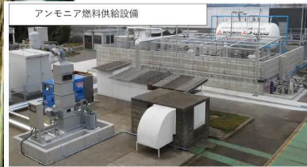
アンモニア燃料供給設備
