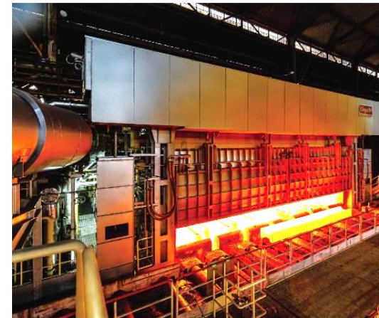
連続鋼片加熱炉
