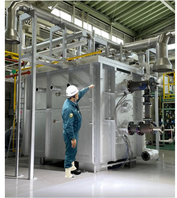
ラジアンチューブ炉 (アンモニア/水素燃烧式鉄鋼プロセス炉の開発)
