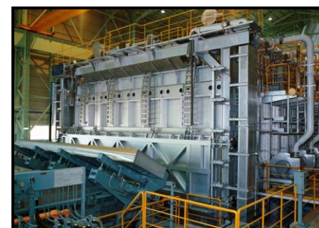
スラブ連続加熱炉
