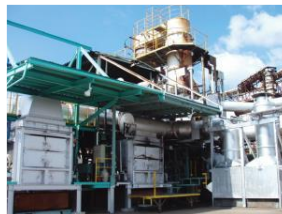
電池の無害化 処理工程
