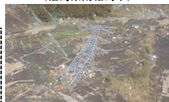
275kV送電鉄塔の倒壊状況 （福島県南相馬市）
