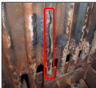
（写真1）ボイラーチューブの破孔
