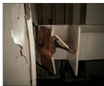
（写真3）ボイラー鉄骨の変形
