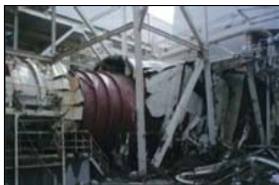
(写真2)通風機の被害
