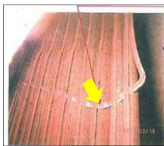
（写真2）クーリングスパーサー管の変形
