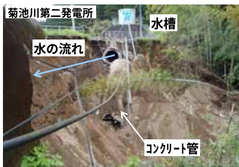
水圧管路 (コンクリート管) 一部破損 (脱落)
