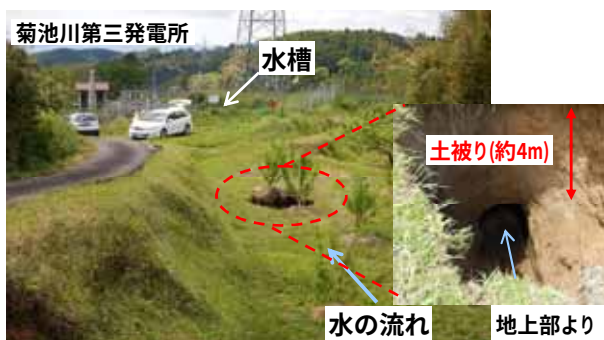
導水路トンネルアーチ部一部崩落
