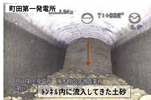
導水路トンネルアーチ部一部崩落 (自走式カメラにより確認)
