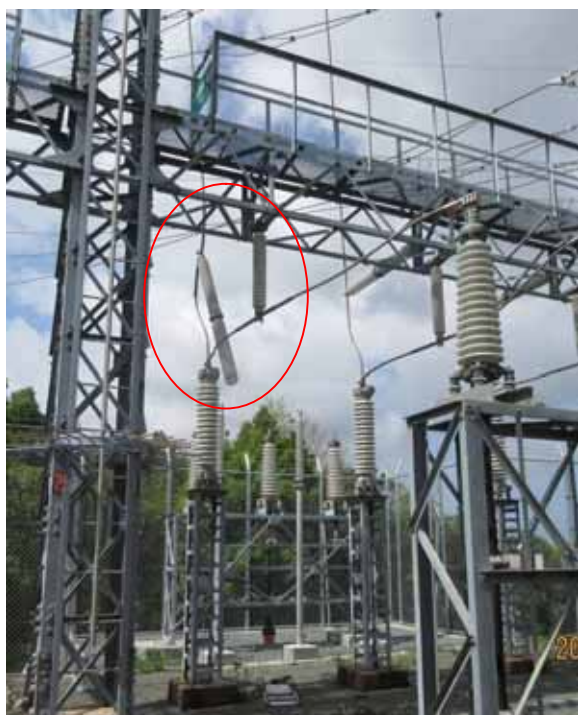
66kV熊本大津線1号線№2-7
