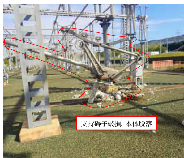
【支持碍子破損、本体脱落】
